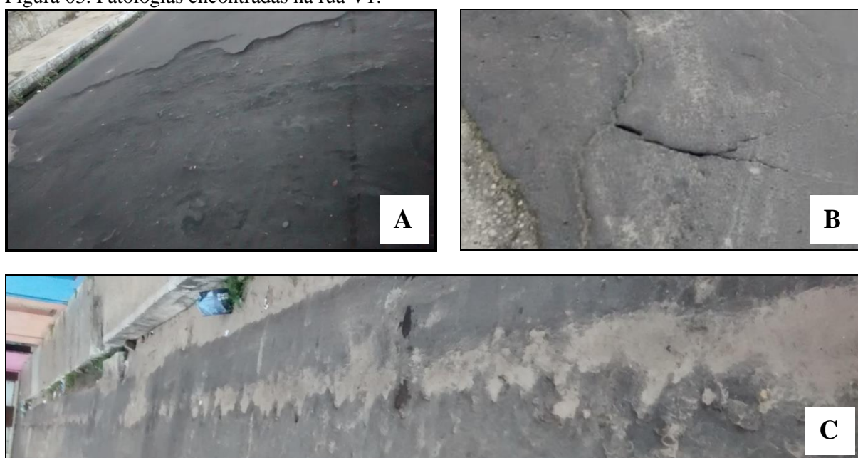
Figura 03. Patologias encontradas na rua V1.
