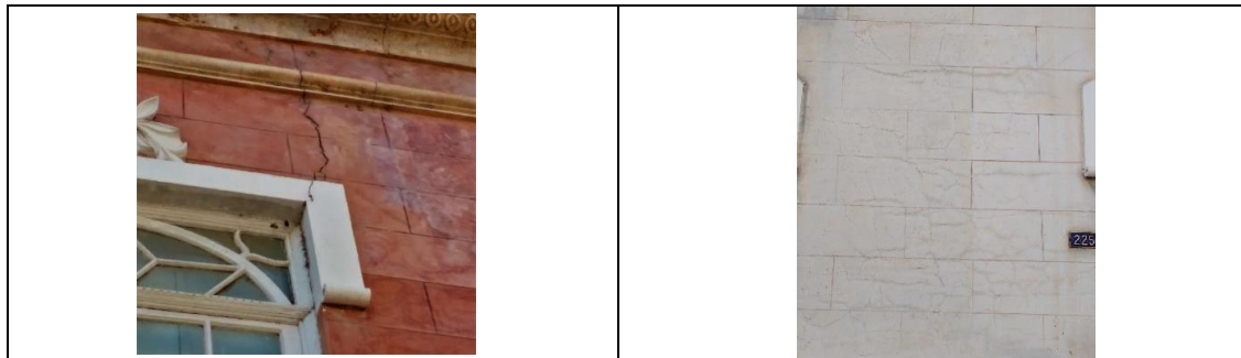
Figura 3. Fissuras encontradas na fachada frontal da Casa Inglesa
