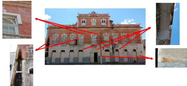
Figura 2. Danos encontrados na Fachada Frontal da Casa Inglesa
