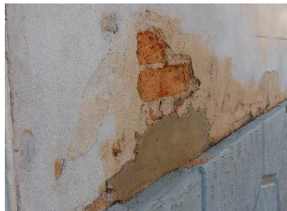
Figura 5. Descolamentos encontrados na fachada frontal da Casa Inglesa
