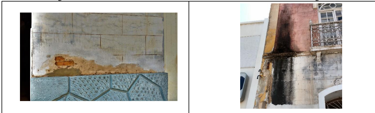
Figura 4. Eflorescência e bolor encontrados na fachada frontal da Casa Inglesa
