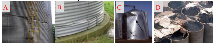
Figura 1. Algumas causas de acidentes em silos
