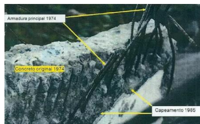
Figura 4. Reforço do capeamento de concreto sem reforço na armadura metálica. Fonte Portal G1, 2014.
