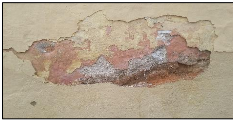
Figura 6. Deslocamento do reboco
