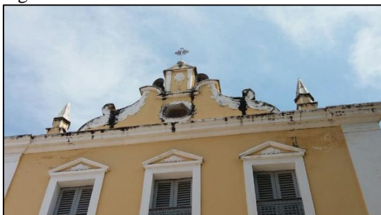
Figura 4. Fachada com manchas de umidade
