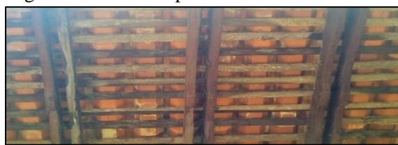
Figura 3. Sinais de apodrecimento da madeira
