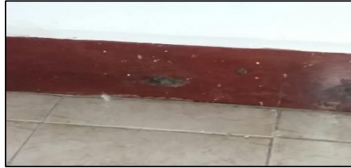
Figura 7. Rodapés comprometido por cupins
