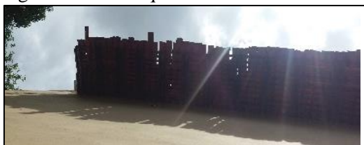
Figura 2. Telhas quebradas e afastadas
