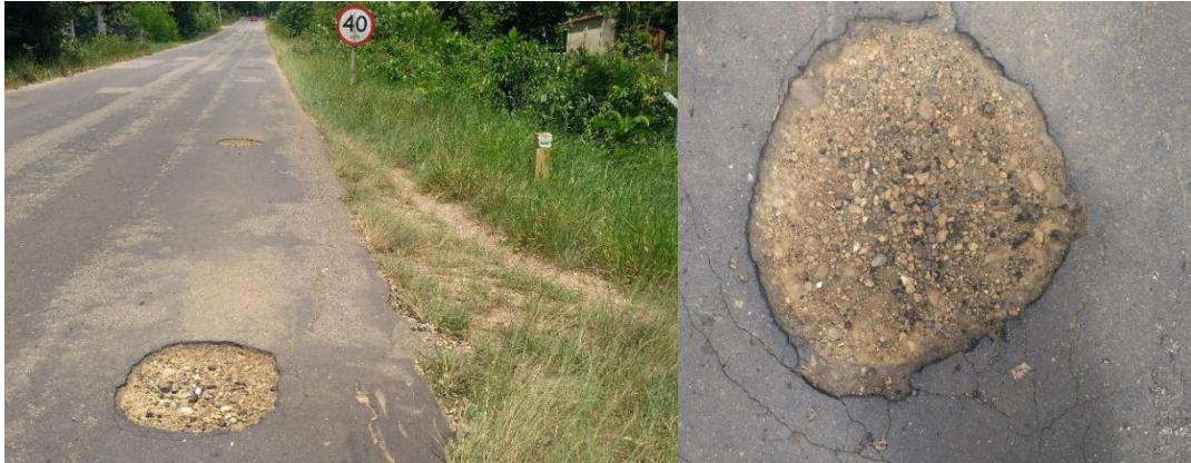
Figura 4. Panelas encontradas na SE-065
