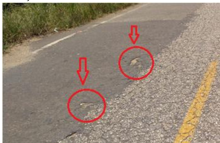
Figura 3. Início de deterioração em remendo da SE-065
