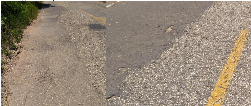
Figura 5. Desgaste de superfície encontrados na SE-065
