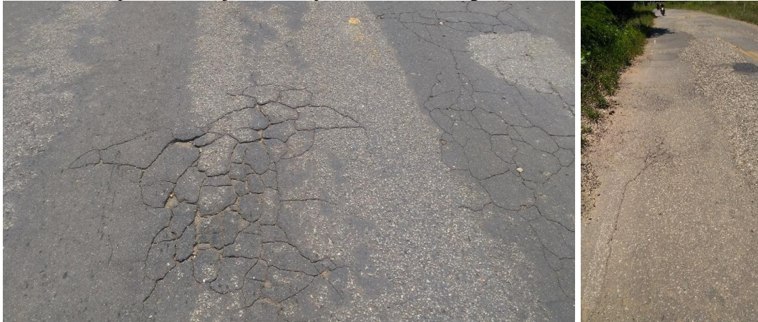
Figura 2. Trincas tipo couro-de-jacaré (esquerda) e trinca longitudinal (direita) encontradas na SE-065
