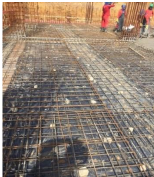
Figura 3 – Pedras sendo utilizadas como substitutas de espaçadores
