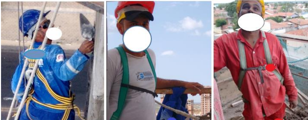
Figura 2. Não utilização de todos os EPIs pelos trabalhadores que utilizam os andaimes suspensos.
