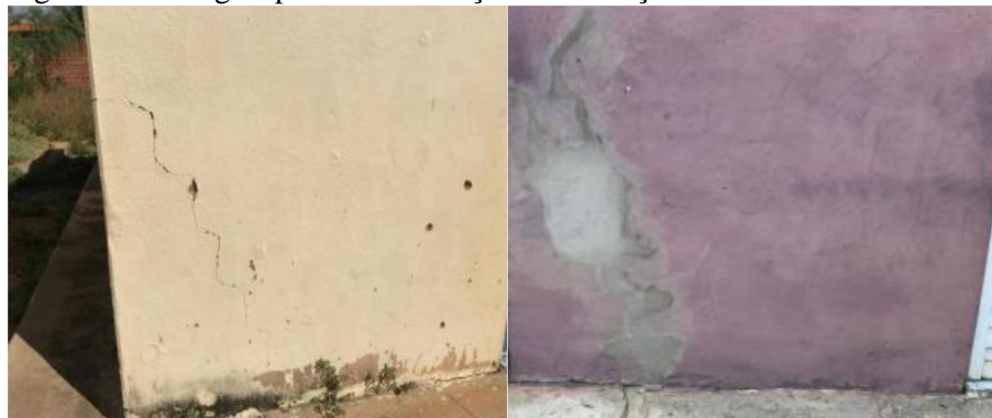
Figura 2. Patologias por movimentação da fundação
