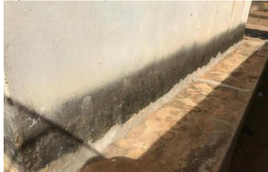
Figura 5. Presença de bolor
