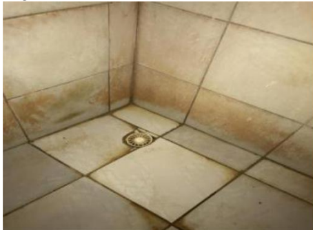
Figura 3. Piso com umidade
