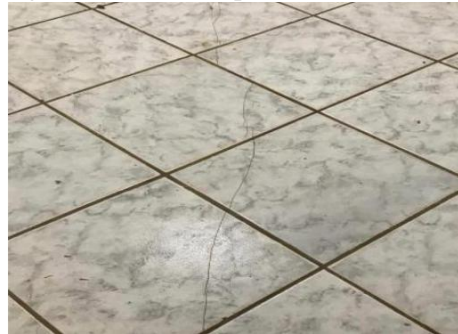
Figura 4. Fissura no piso
