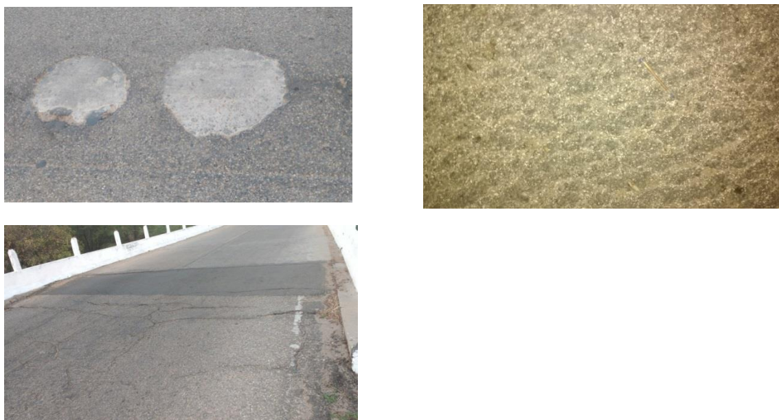
Figura 2. Patologias encontradas durante o trecho urbano da rodovia RN-263
