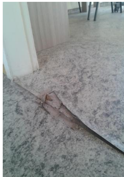
Figura 03: piso vinílico descolado
