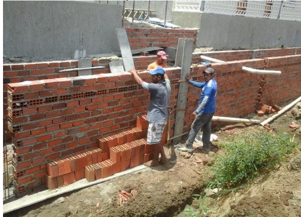
Figura 3. Trabalhadores sem EPI's e em condições insalubres.
