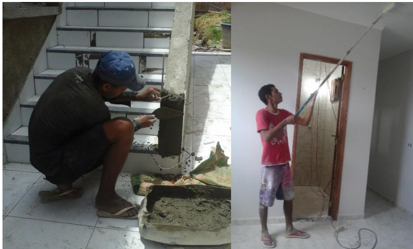
Figura 2. Trabalhadores sem EPI's.
