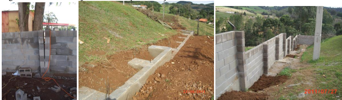
Figura 2. Problema em junta de dilatação e solução adotada
