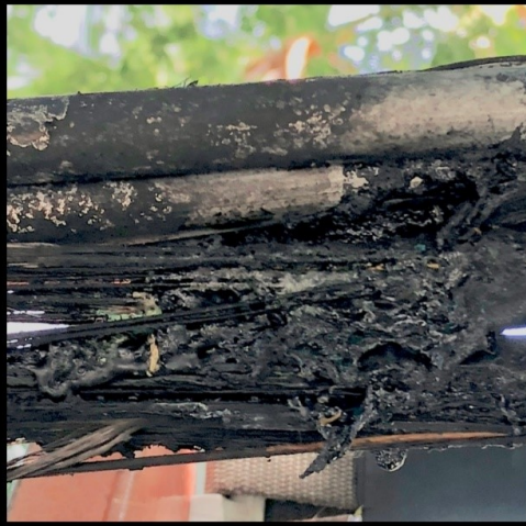
Incêndio Rede de cabos ópticos aéreos
