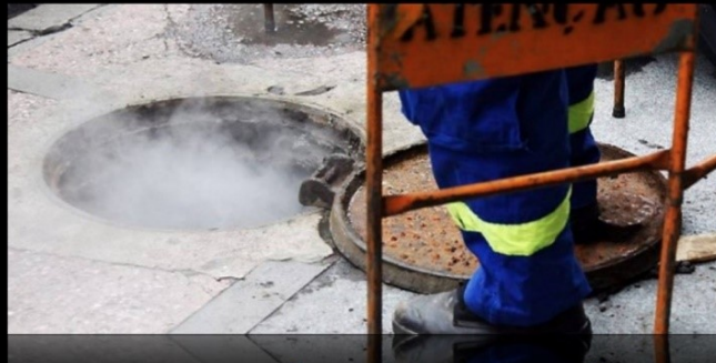
CAIXAS E/OU CÂMERAS SUBTERRÂNEAS COM PRESENÇA DE GÁS
