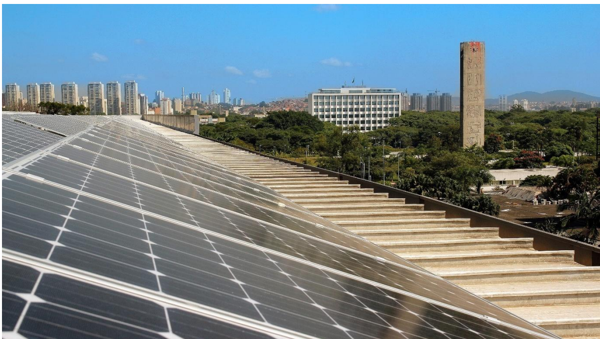
Figura 24. Painéis fotovoltaicos instaladas na cobertura de um prédio.
