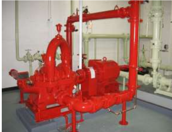
Figura 07: Bomba de Hidrante: Disponível em http://www.rwengenharia.eng.br/
