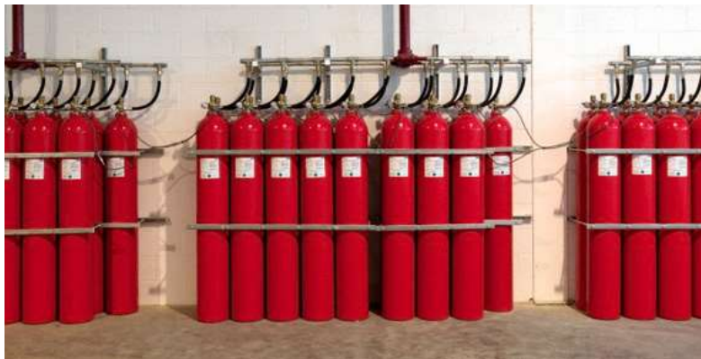
Figura 08: Sistema Fixo de Gases Limpos de Combate a Incêndio. Disponível em http://projecendio.com.br/
