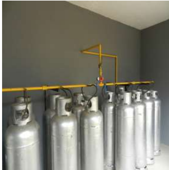
Figura 3: Central de GLP. Disponível em: https://www.centraldevazamentos.com.br
