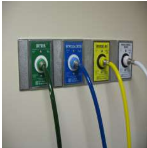
Figura 2: Saída de gases medicinais, conforme identificação.
