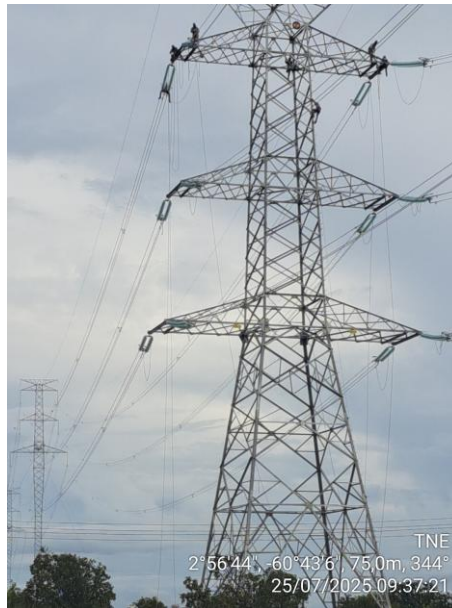
Foto 1 Estrutura da Linha de 500kV, no ponto de conexão
