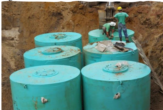
Figura 6: Sistema anaerobio enterrado fabricado com Tanques em ferro 3,00 m x 3,00m
