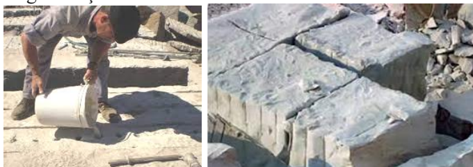
Figura 1- Ilustração de aplicação no furo da Argamassa Expansiva no furo e a fragmentação da rocha.
