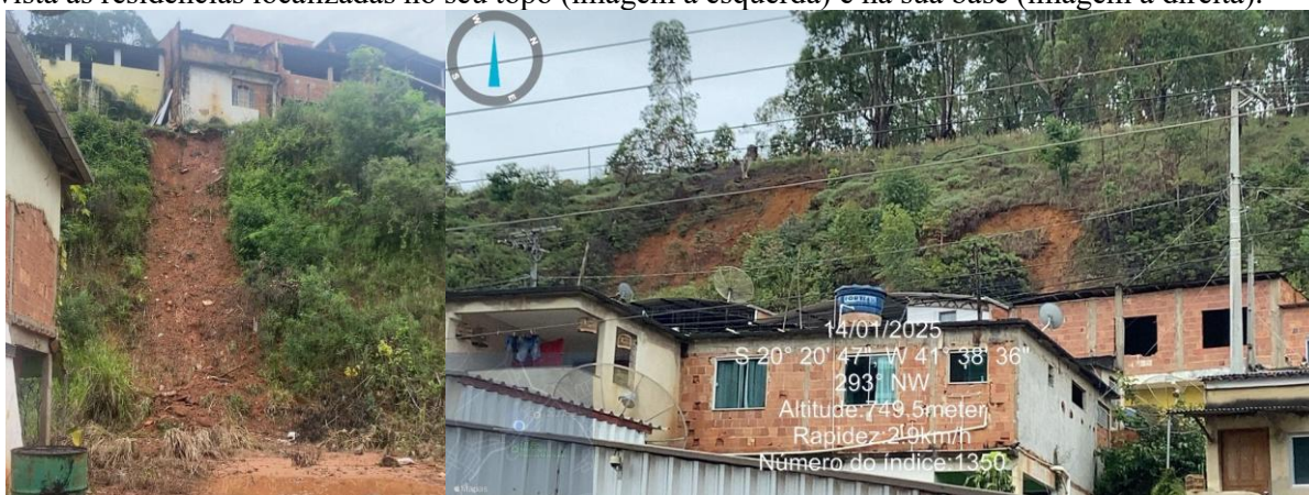
Figura 3. Taludes altamente inclinado propenso a movimento de massa, evidenciando o risco tendo em vista as residências localizadas no seu topo (imagem à esquerda) e na sua base (imagem à direita).
