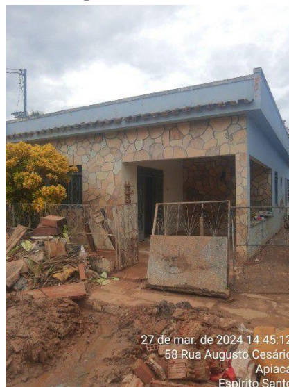
Figura 4. Casa onde o alagamento afetou o padrão de entrada de energia elétrica.
