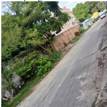
Figura 2 – Condições gerais da via e da microdrenagem
