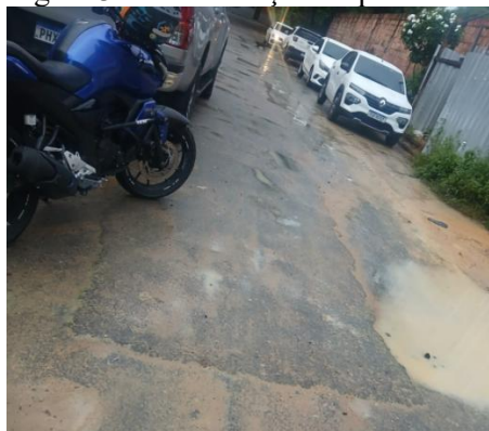
Figura 3 – Deterioração do pavimento
