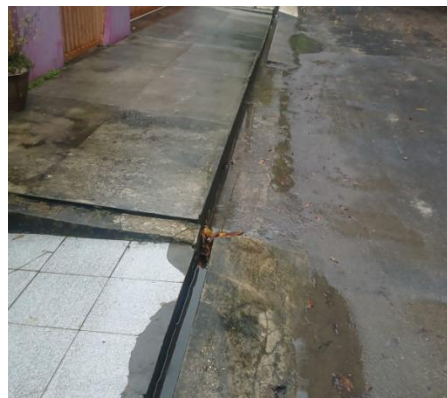
Figura 4 – Acúmulo de água e deficiência de escoamento
