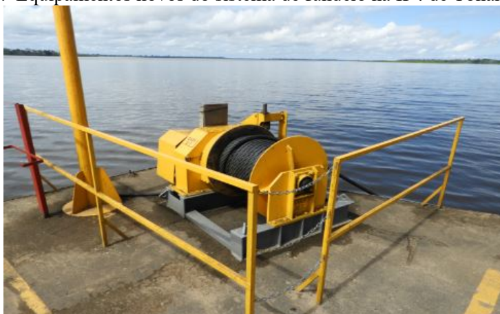
Figura 2. Equipamentos novos do sistema de fundeio na IP4 de Tonantins/AM.
