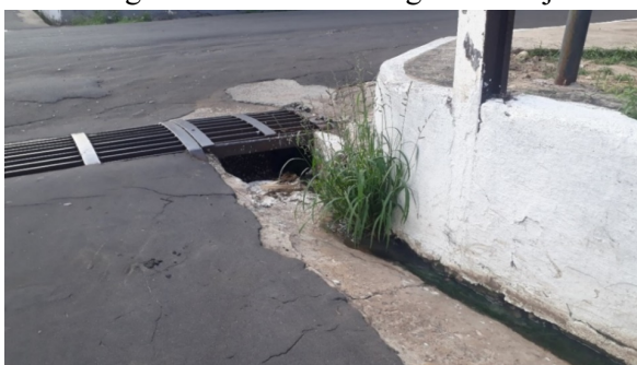
Figura 8. Canaleta com grade e sarjeta
