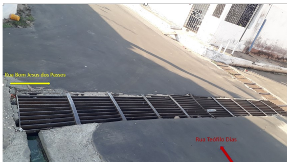
Figura 4. Canaleta com grade no sentido transversal da rua Teófilo Dias.
