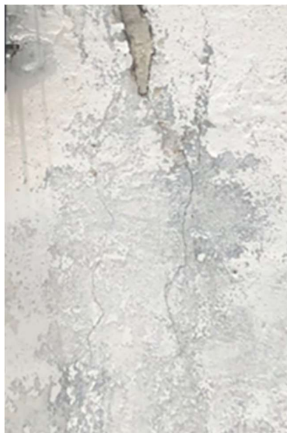
Figura 3. Fissuras na argamassa de revestimento
