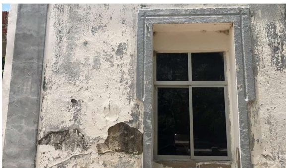
Figura 4. Bolor e Descascamento de pintura
