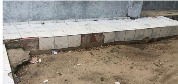
Figura 7. Deslocamento da cerâmica
