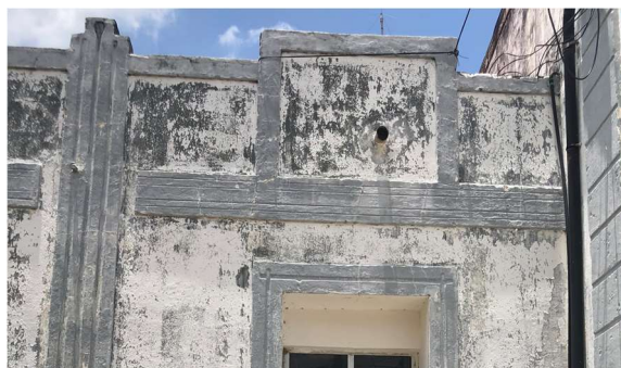
Figura 5. Sujidade em todo pano de parede
