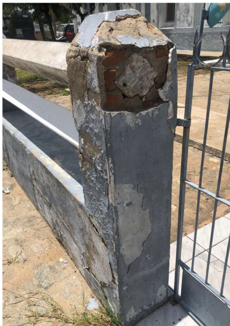
Figura 8. Desprendimento do Revestimento Argamassado
