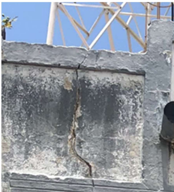
Figura 2. Platibanda apresentando Fissura e sujidade
