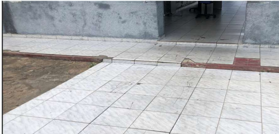
Figura 6. Deslocamento da cerâmica
