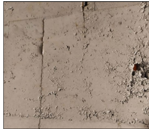
Figura 2 - Falha na Concretagem
