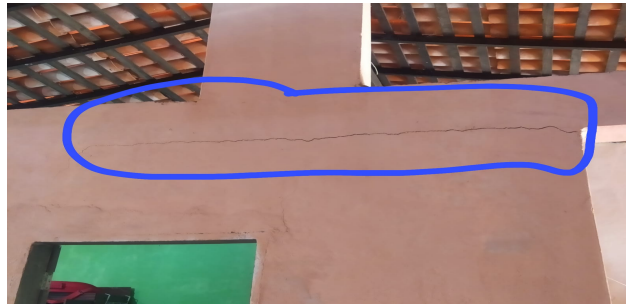
Figura 3 – Tipo de fissura encontrada nas residências visitadas
