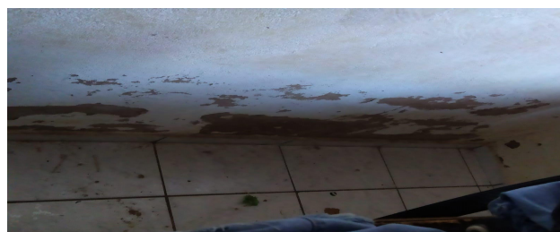
Figura 2 – Umidade por capilaridade.
