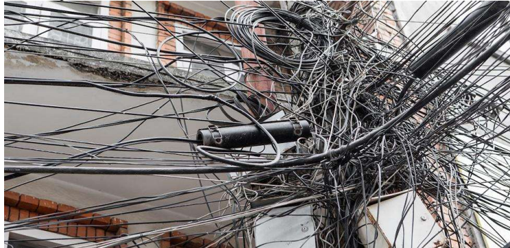
Figura 1. Exemplo de um poste de transmissão sobrecarregado.
