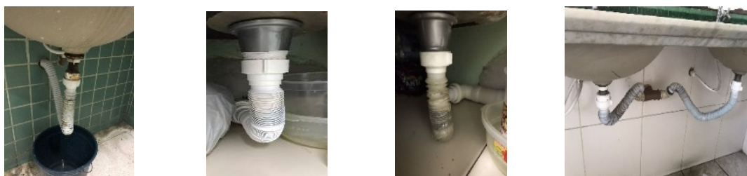
Figura 4. Exemplos de instalações danificadas no prédio.
