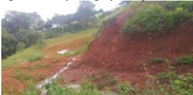
Figura 3: Percolação de água para a represa.
