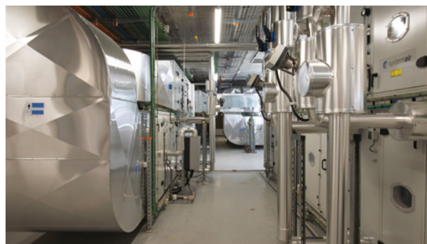
Área técnica de AVAC
