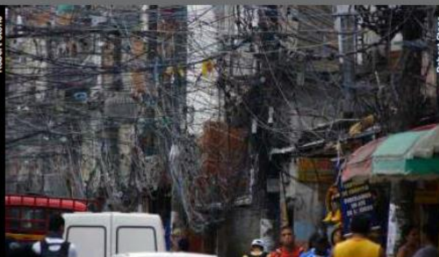
Fios elétricos numa favela no Brasil
