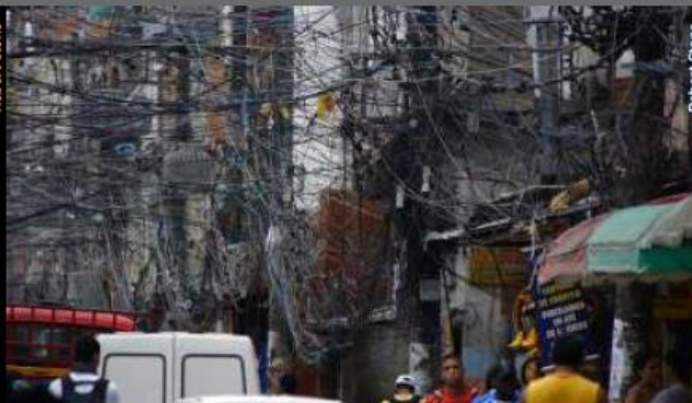
Fios elétricos numa favela no Brasil
