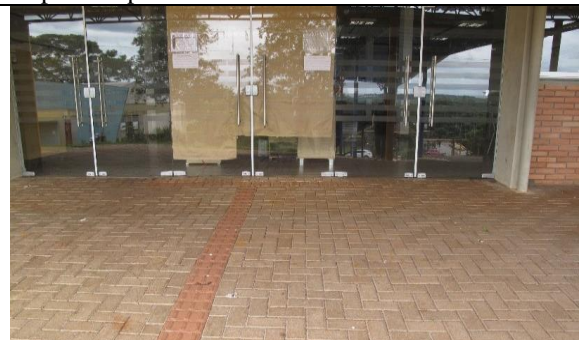
g) Piso tátil alerta direcional externo, disposto de forma incorreta.
