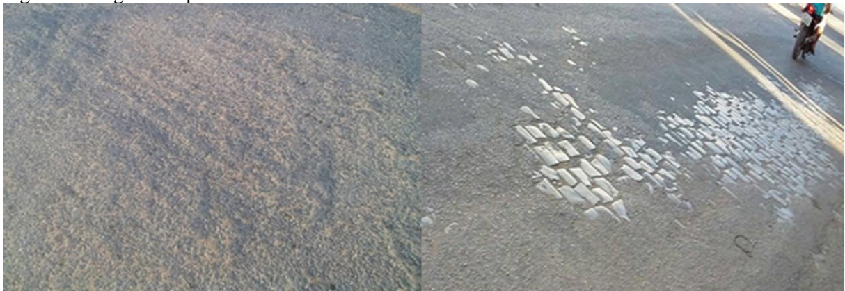
Figura 4. Desgaste do pavimento.
