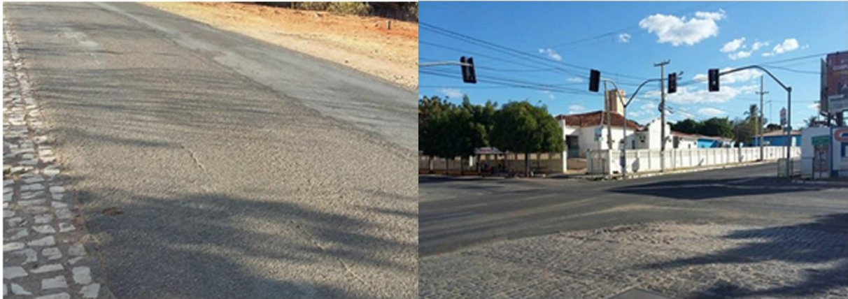
Figura 1. Ausência da sinalização vertical e horizontal.
