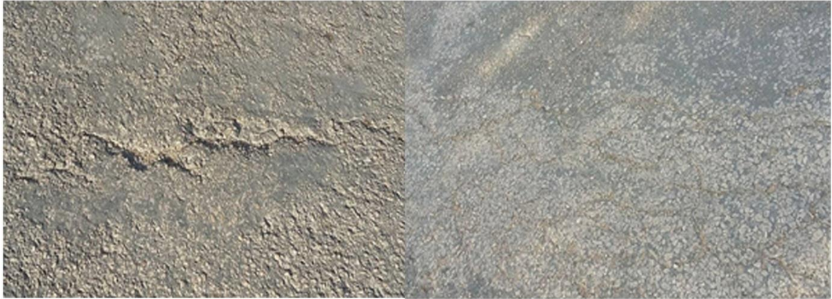
Figura 3. Presença de fendas no pavimento.
