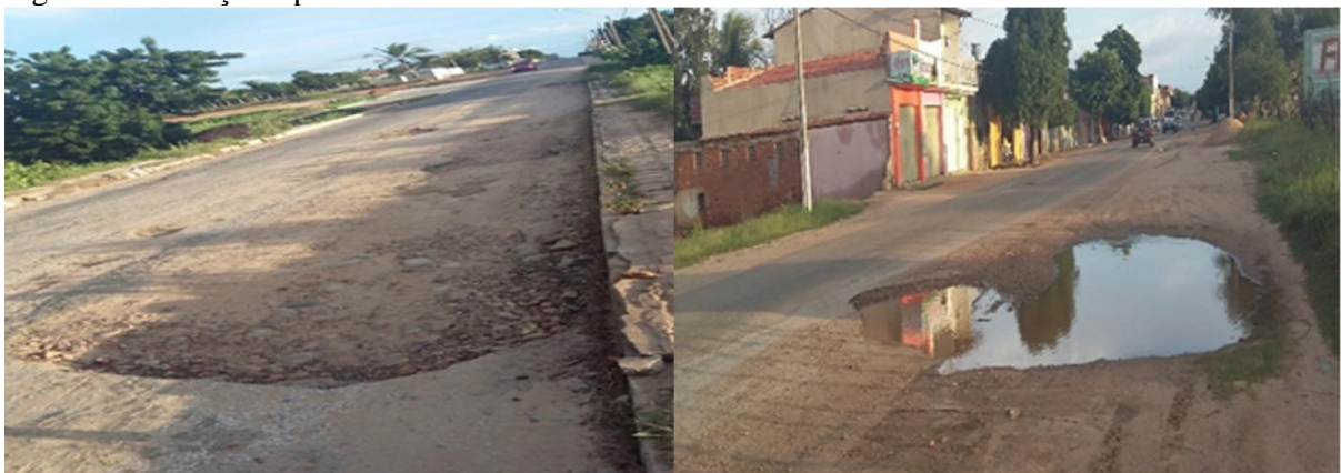
Figura 5. Presença de panelas no trecho.
