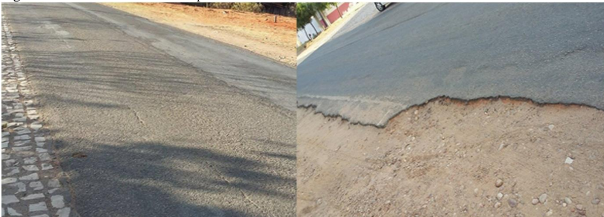
Figura2. Ausência das obras complementares.
