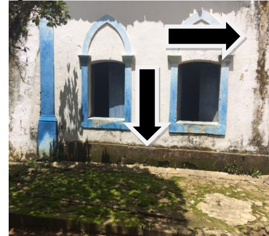
Figura 4: Eflorescência na fachada
