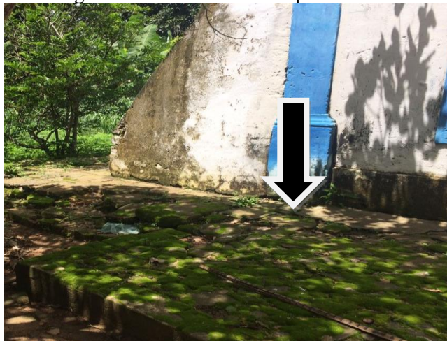
Figura 5: camada de lodo na parte externa
