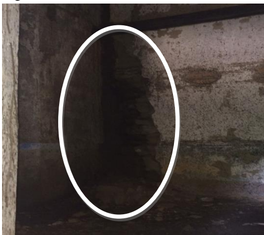
Figura 3: Desabamento interno na alvenaria
