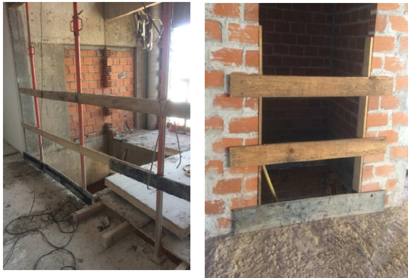
Figura 1. Abertura piso Obra 7. Figura 2. Abertura piso Obra 8.
