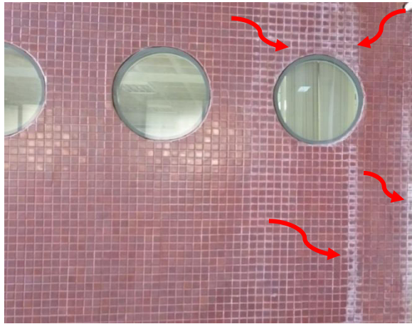
Figura 4. Visualização patológica de eflorescência.
