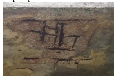
Figura 6 – Destacamento do concreto e exposição da armadura corroída
