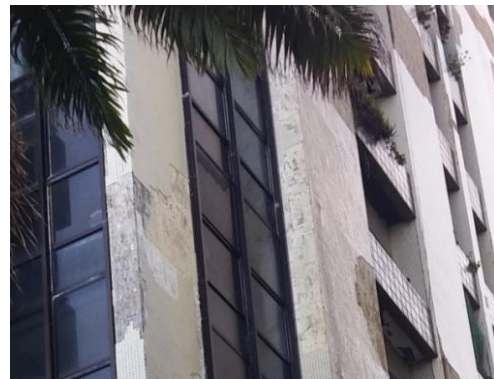
Figura 2 – Descolamento de cerâmica em fachada
