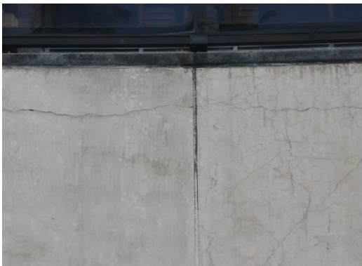
Figura 1 – Trincas em revestimento cerâmico do muro
