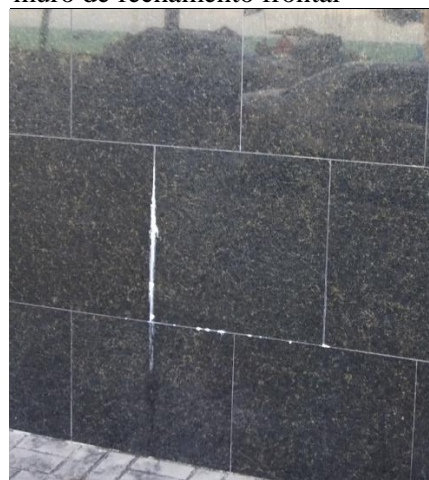
Figura 5 – Eflorescência em área externa do muro de fechamento frontal
