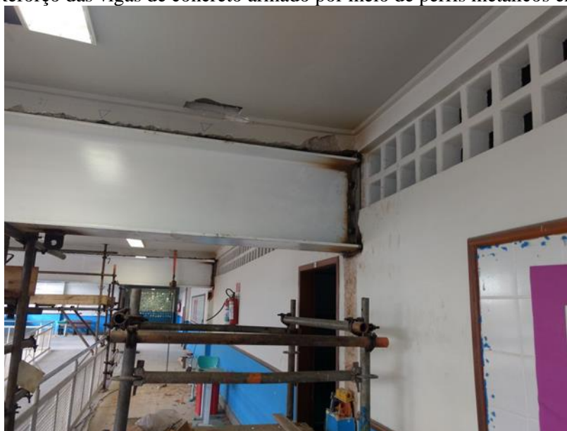
Figura 1: Reforço das vigas de concreto armado por meio de perfis metálicos em execução.
