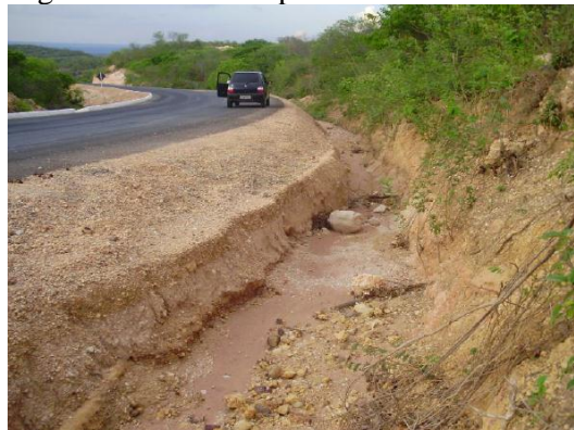
Figura 1. Erosão no pé do aterro
