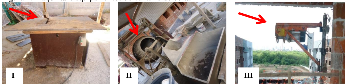
I: serra elétrica; II: betoneira; III: visão lateral do guincho de coluna. Fonte: Dados da pesquisa (2018).
