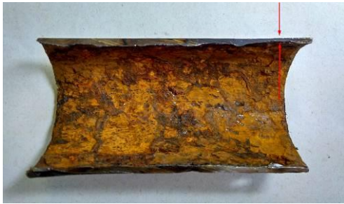
Figura 72 - Variação da espessura da parede devido à corrosão.
