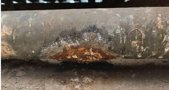
Figura 1 - Corrosão externa no barrilete
