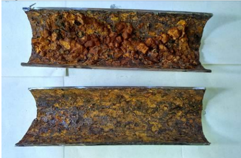
Figura 3 – Corrosão interna da tubulação de 1.1/2”.
