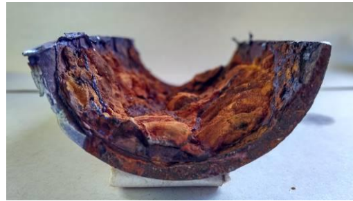
Figura 8 - Tuberculização da tubulação de 1”
