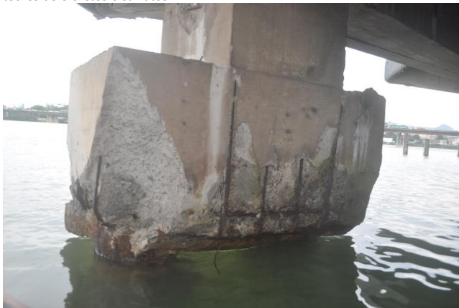
Figura 1. Evidência da expansão da armadura na faixa de variação da maré, devido às sucessivas e frequentes imersões temporárias do concreto estrutural em água com altos teores de cloretos e sulfatos
