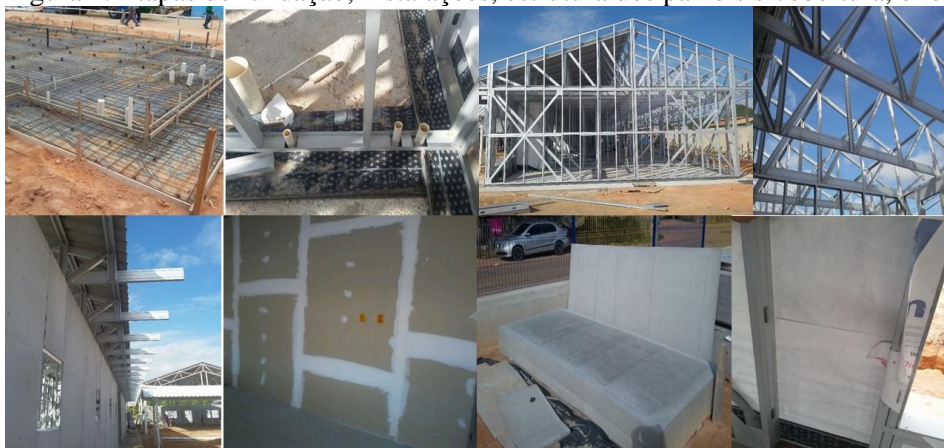
Figura 1. Etapas de fundação, instalações, estrutura dos painéis e cobertura, e fechamento dos painéis
