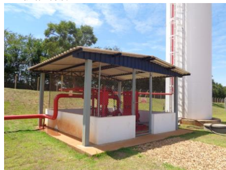
Figura 2: Casa de bombas do sistema de hidrantes.
