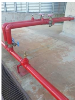
Figura 1: Cavalete hidráulico para acionamento dos bicos aspersores.
