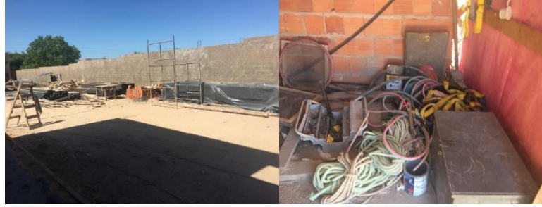
Figura 3 e 4 – Desorganização do canteiro de obra e almoxarifado
