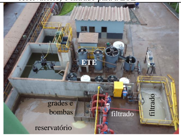
Figura 8 – Gradeamento e bombas (no reservatório) e filtrado para a ETE
