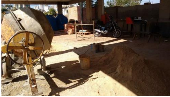
Figura 2. Agregados sem dispositivos de contenção e proteção. Fonte: Autoria própria.
