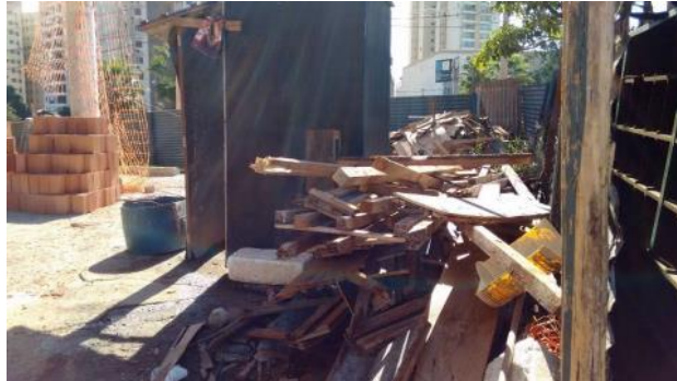
Figura 3. Entulhos de resíduos diversos encontrados no canteiro. Fonte: Autoria própria.
