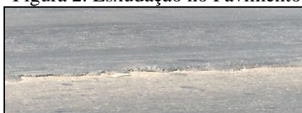
Figura 2. Exsudação no Pavimento
