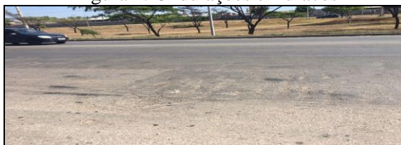
Figura 4. Ondulações e Buracos
